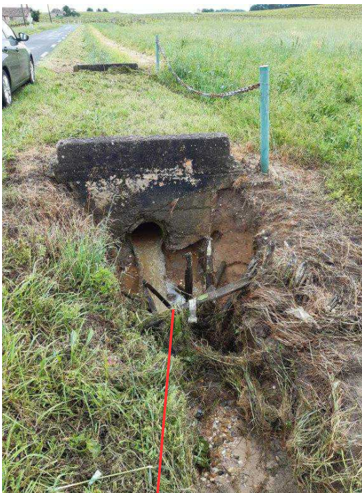
Illustration 4: Le fossé à 12h45. La perte active est à ce niveau et elle a baissé en débit
