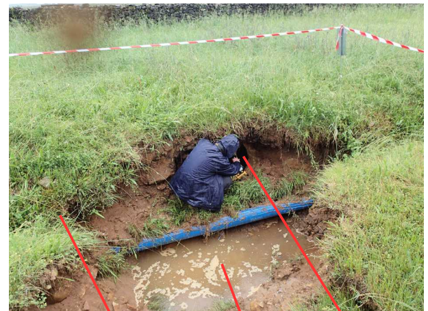
Illustration 6: Vue de l'effondrement du fossé et de la perte
