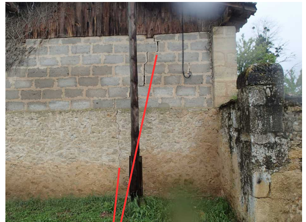
Illustration 5: Fissures sur le mur de la maison attenante à l'effondrement. Il y a des fissures aussi sur le mur au dessus de l'effondrement
