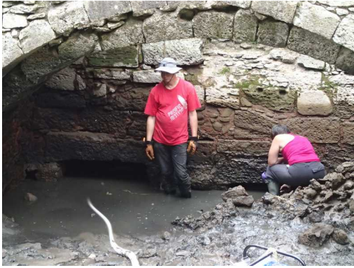
Illustration 3: Les sorties d'eau aval du moulin se révèlent. Remarquer les eaux très boueuses qui ralentissent le débit de la pompe.
