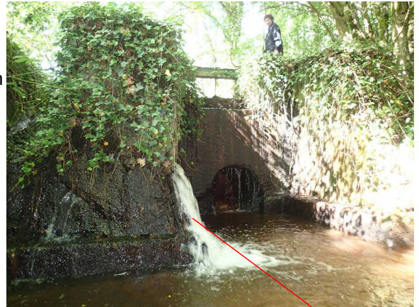
Illustration 3: L'aval du barrage qui alimente le Goua Sec. Fuite d'eau
