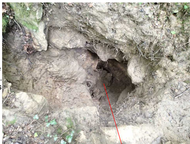
Illustration 2: Le puits à la fin de la journée. on voit bien les éboulis au fond.
