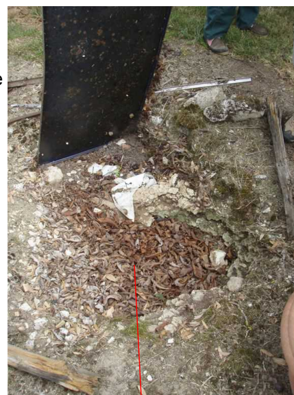
Illustration 1: L'effondrement : D-Lig-Pauverts-X436441_Puits bouché
